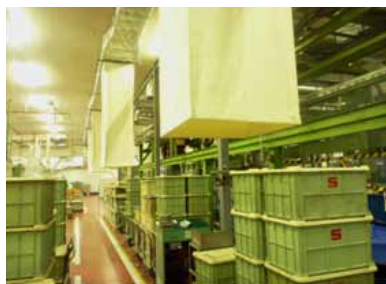
空調吹き出しダクト
