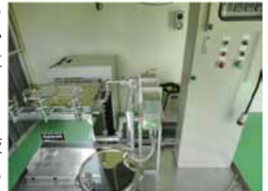
新設の油除去装置
