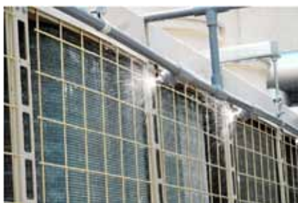
チラー室外機への水噴霧
