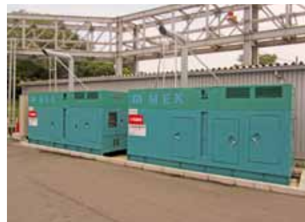
自家発電装置
